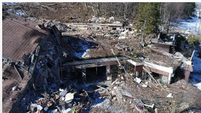
HOTEL RIGOPIANO DISTRUTTO DA UNA VALANGA
